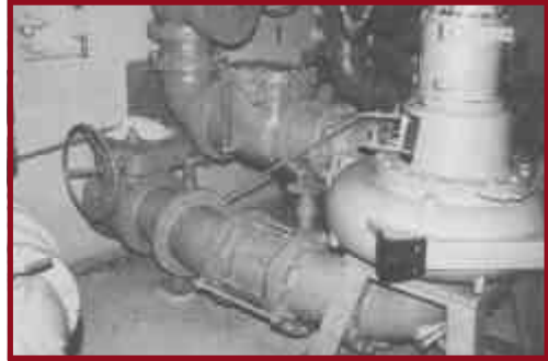
Figura 31. Acoplamientos flexibles en la succión y descarga de la bomba de aguas residuales.
