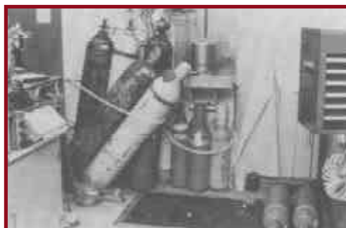
Figura 39. Cilindros de gas comprimido sujetos con una sola cadena que se cayeron.
