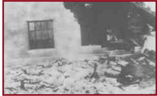
Figura 61. Edificación de mampostería no reforzada que colapsó parcialmente.
