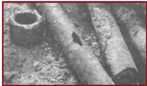
Figura 69. Tubería corroída que colapsó en el terremoto de Coalinga, California.
