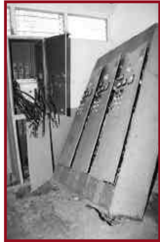
Figura 58. Paneles eléctricos de la estación de bombeo de El Salvador afectados por los terremotos de 2001.
