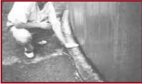
Figura 86. Tanque no anclado que se deslizó en Moin, Costa Rica.
