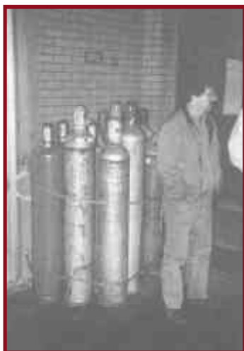
Figura 40. Cilindros de gas comprimido sujetos con cadenas por arriba y por abajo en la instalación de Seattle Metro, Washington.
