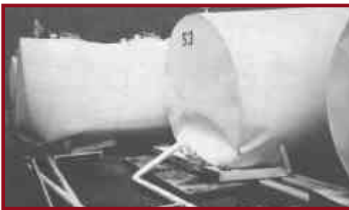
Figura 44. Tanques de combustible horizontales que colapsaron por no contar con estructuras adecuadas de apoyo longitudinal con abrazaderas en Limón, Costa Rica.
