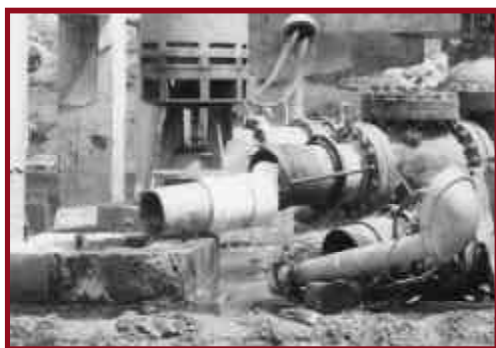
Figura 18. Campo de pozos afectado por el terremoto de El Salvador del año 2001; entre otros daños, hubo rotura de tuberías y desacople de uniones.
