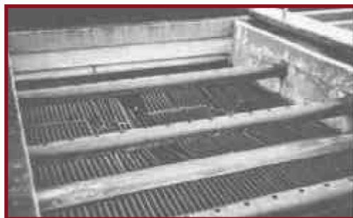
Figura 23. Los deflectores del floculador y las placas inclinadas del clarificador que resultaron dañados en la planta de tratamiento de agua de Limón, Costa Rica.
