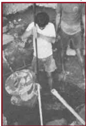
Figura 21. La tubería de revestimiento del pozo que se dobló 15° de la vertical como resultado del flujo lateral en Dagupan, Filipinas.
