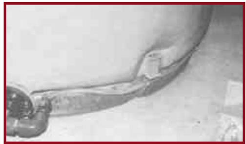
Figura 45. Los tanques con sustancias químicas no anclados pueden deslizarse y romper las tuberías de conexión.
