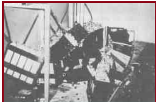
Figura 60. Baterías no ancladas que se desplomaron.
