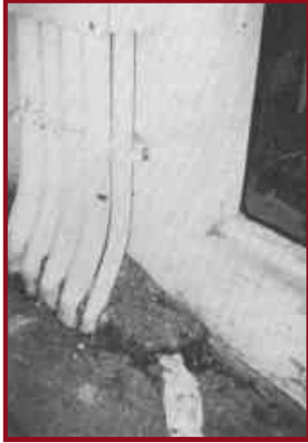
Figura 28. Agrietamiento debido al asentamiento diferencial del terreno alrededor de la estructura soportada por pilotes de la planta de tratamiento.
