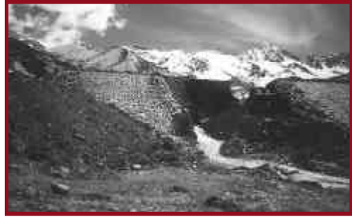
Figura 16. Daño en muro de represa.
