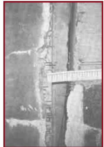
Figura 85. Tanque con malla de acero de la década de los sesenta que falló en el terremoto de Loma Prieta, California.
