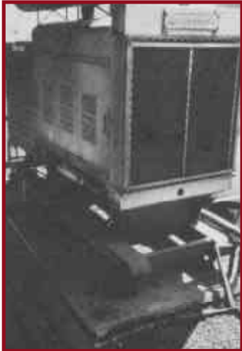
Figura 35. Aislador dañado en un grupo electrógeno.
