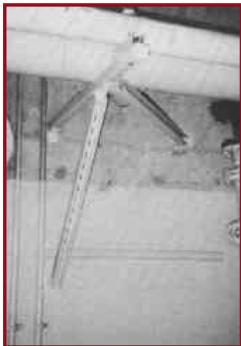
Figura 29. Tuberías apoyadas en tres direcciones ortogonales.
