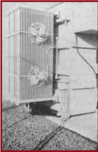
Figura 56. Transformador anclado en la planta de tratamiento del distrito municipal de servicios públicos de East Bay, California.
