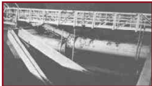
Figura 24. Reactor-clarificador de la planta de tratamiento de agua de Rinconada, California, dañado seriamente por la presión hidráulica.
