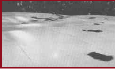
Figura 83. Daño al techo del tanque de acero debido al movimiento oscilatorio del contenido producido por el terremoto de Loma Prieta, California
