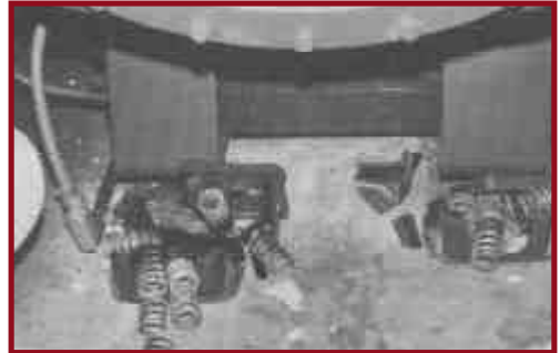
Figura 36. Vibración de resorte en un grupo electrógeno dañado durante el terremoto de Whittier, California.
