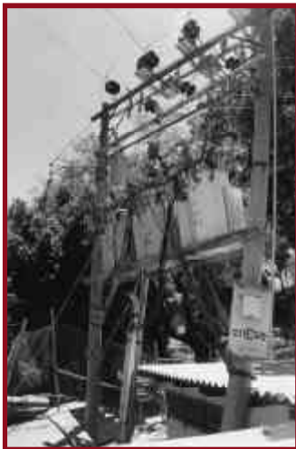
Figura 53. Transformadores que servían a un campo de pozos y estación de bombeo dañados a causa del terremoto de El Salvador, 2001.
