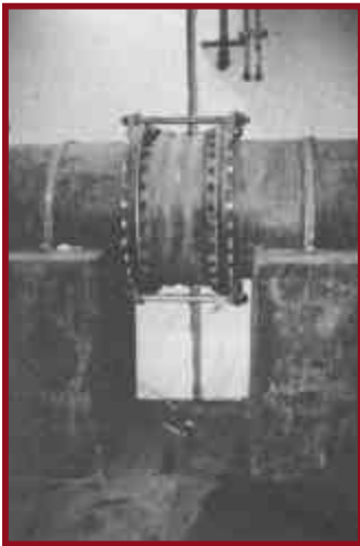
Figura 32. Unión flexible en una tubería que cruza una junta en la estructura del edificio.
