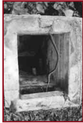
Figura 19. Pérdida de la fuente de agua de vertiente después de un sismo intenso en el Salvador.
