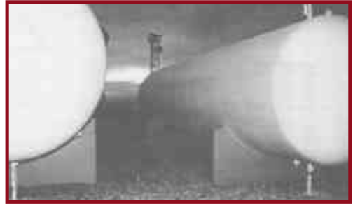
Figura 43. Los tanques grandes de propano pueden resbalarse longitudinalmente y romper las tuberías de conexión.
