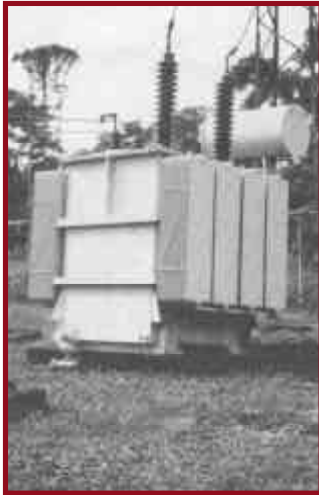
Figura 52. Transformador no anclado vulnerable a fuerzas sísmicas.
