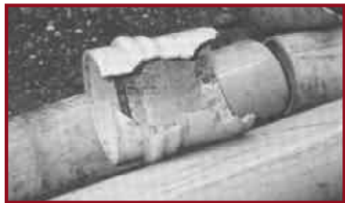
Figura 71. Rotura por compresión en la unión de la tubería de PVC causada por el flujo lateral.
