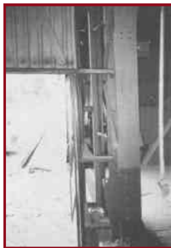
Figura 64. Edificio de pórticos arrios-trados de acero en Moin, Costa Rica, donde un arriestre fue removido. El sismo dejó el edificio permanentemente torcido.
