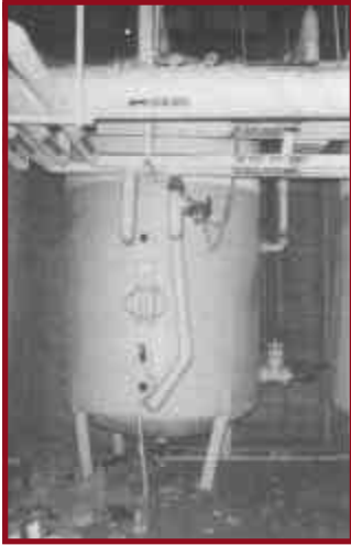
Figura 47. Soportes del tanque no arriostrados que se torcieron en el terremoto de San Fernando, California.
