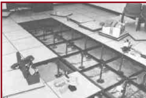
Figura 50. Falsos pisos para computadoras vulnerables al colapso.
