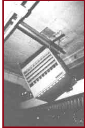
Figura 49. Soporte de la unidad de calefacción, ventilación y aire acondicionado que colapsó en el terremoto de Loma Prieta, California.
