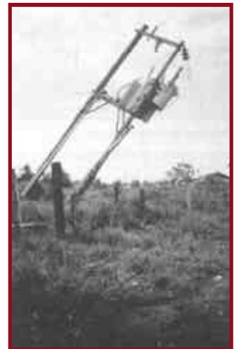
Figura 55. Poste con transformador que se volcó como resultado de la licuefacción de su base en Costa Rica.
