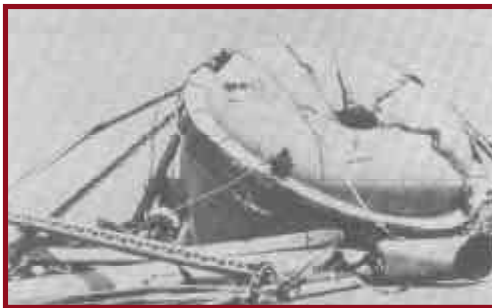
Figura 93. Colapso de un tanque elevado.
