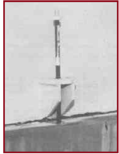
Figura 91. Conexión de pared-base de tanque no anclado con rotura y vaciado de su contenido tan rápidamente que implosionó la parte superior.
