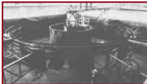
Figura 25. Deflectores dañados en el clarificador secundario debido al terremoto de Loma Prieta, California.
