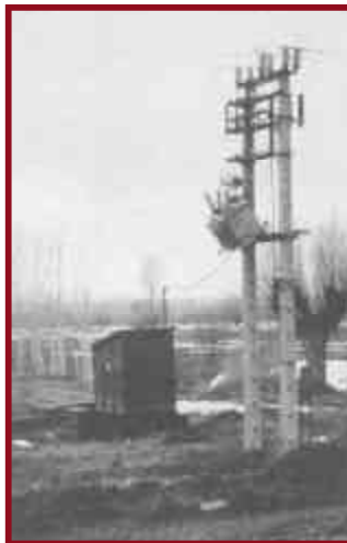
Figura 54. Transformador sobre un poste no anclado que se desplomó en Erzincan, Turquía.
