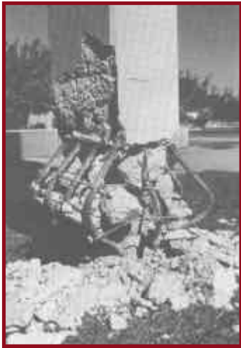
Figura 62. Ruptura en la columna no dúctil de concreto, San Fernando, California.
