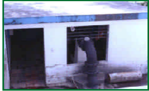
Estación de bombeo y tanque recolector de agua en la fuente de Tajamar.
